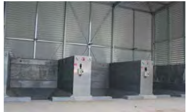
Centre de transfert de NOTH
